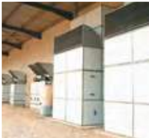
Ventilation répondant aux normes sanitaires et environnementales
