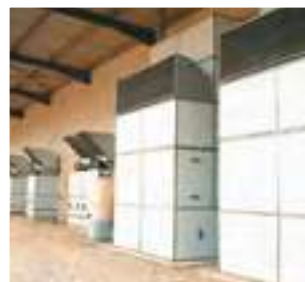
Ventilation répondant aux normes sanitaires et environnementales
