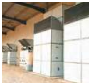
Ventilation répondant aux normes sanitaires et environnementales
