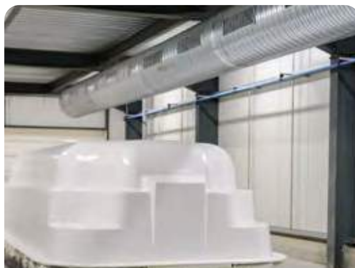
Tunnel d'étuve à 40°C
